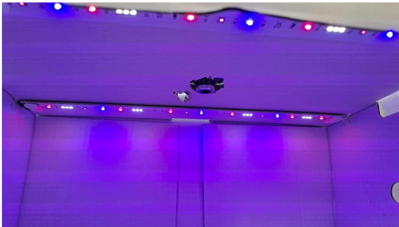
4. Ábra: a LED panelek bekapcsolt állapotban
