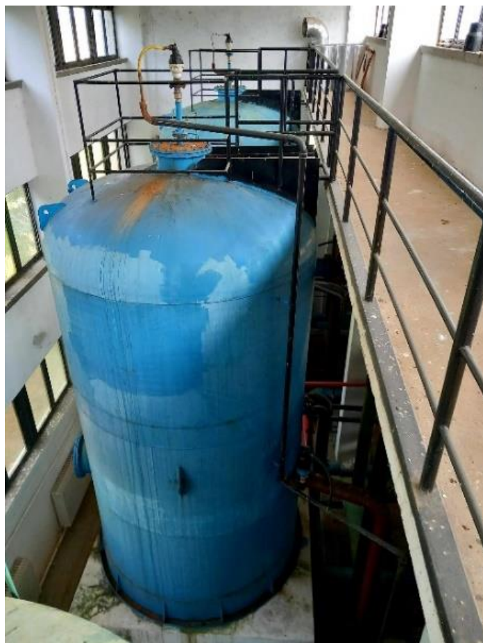
4. fotó: Álló vas és mangán talanító tartályok a Foktő-barákai vízműben Szerző által készített fotó 2024.03.29.
