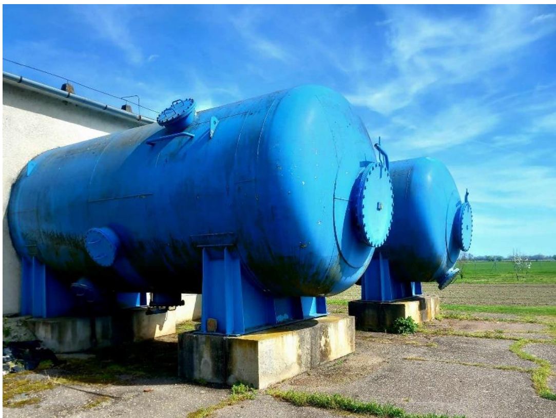
1. fotó: Fekvő vas és mangán talanító tartályok a Foktő-barákai vízműben Szerző által készített fotó 2024.03.29.
