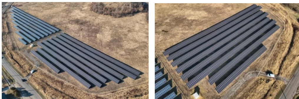
15. ábra: Telepítés utáni képek 2020 november, Kurityán, Forrás: https://villanyautosok.hu/
