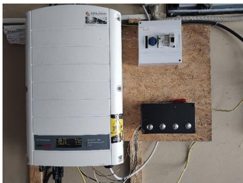
15. ábra Inverter és szabályozó üzemi állapotban
