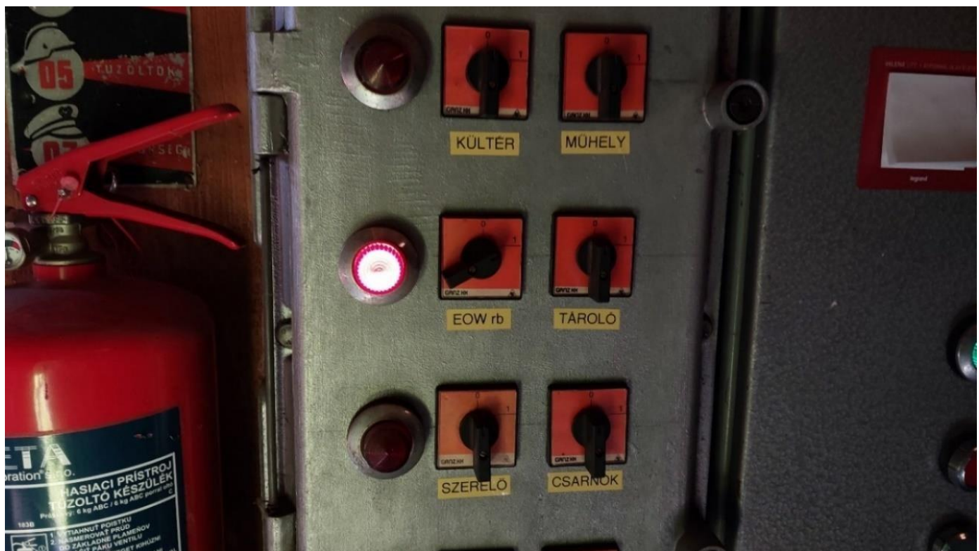
15. ábra Világítási elosztó A2 tokozat, VGK kapcsolókkal (saját kép)
