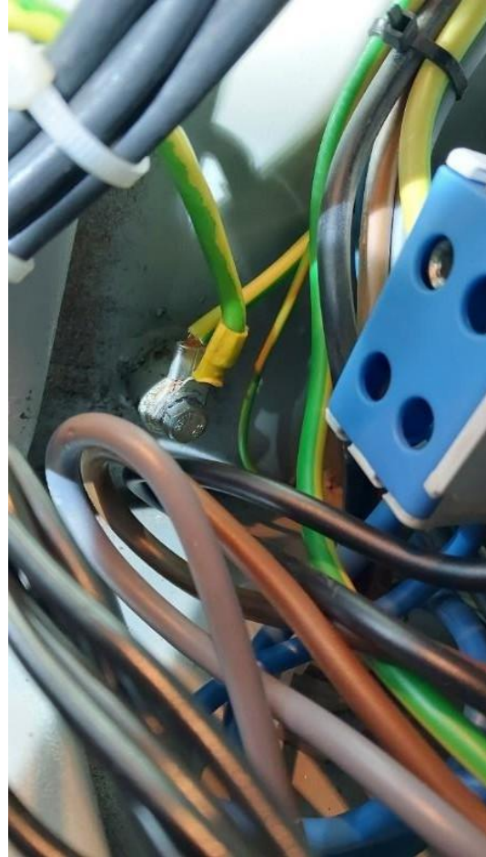
20. ábra Főelosztó EPH csatlakozása (saját kép)
