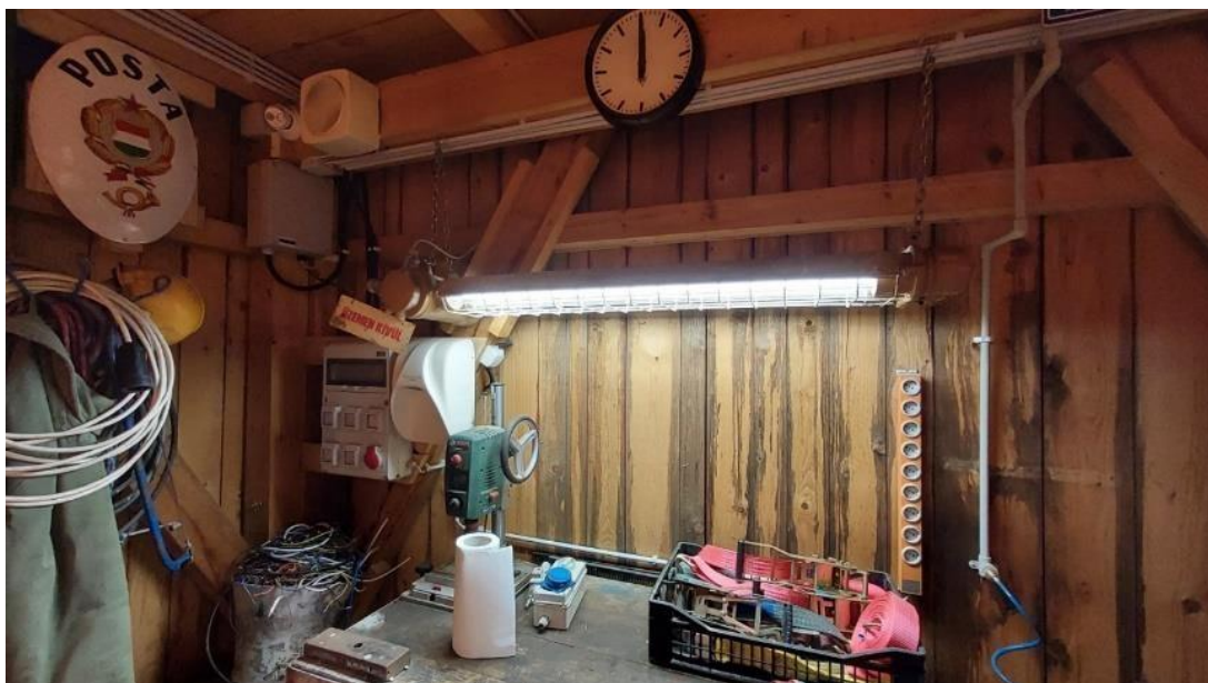
10. ábra EOW Rb 2x40W fénycsöves lámpa és 10 férőhelyes dugalj (saját kép)
