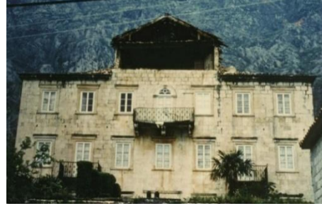
10. ábra – 3-as fokozatú kár falazott épületen az 1979-es montenegrói rengés után (forrás: Grünthal, 1998)
