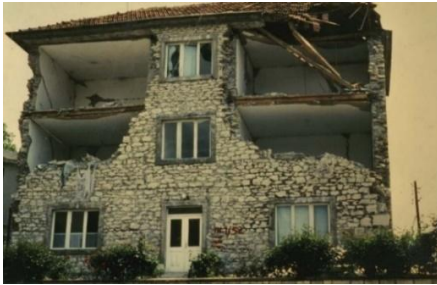
11. ábra – 3-as fokozatú kár falazott épületen az 1979-es montenegrói rengés után (forrás: Grünthal, 1998)
