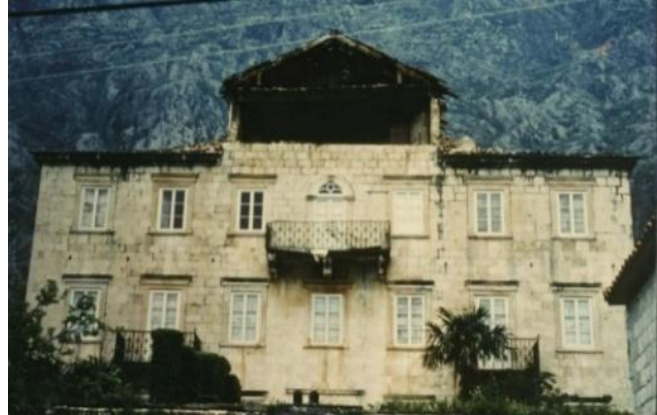
9. ábra – 3-as fokozatú kár falazott épületen az 1979-es montenegrói rengés után (forrás: Grünthal, 1998)
