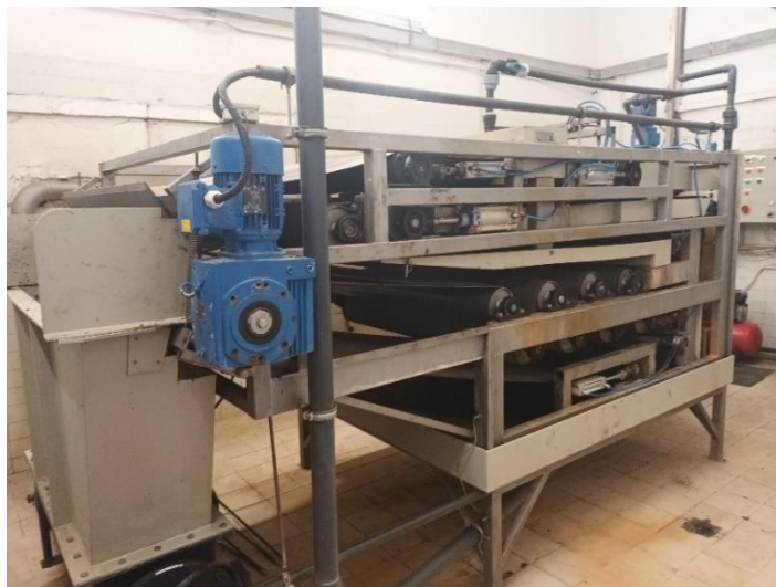
15. ábra: Hajdúhadház szennyvíztelep szalagprés
