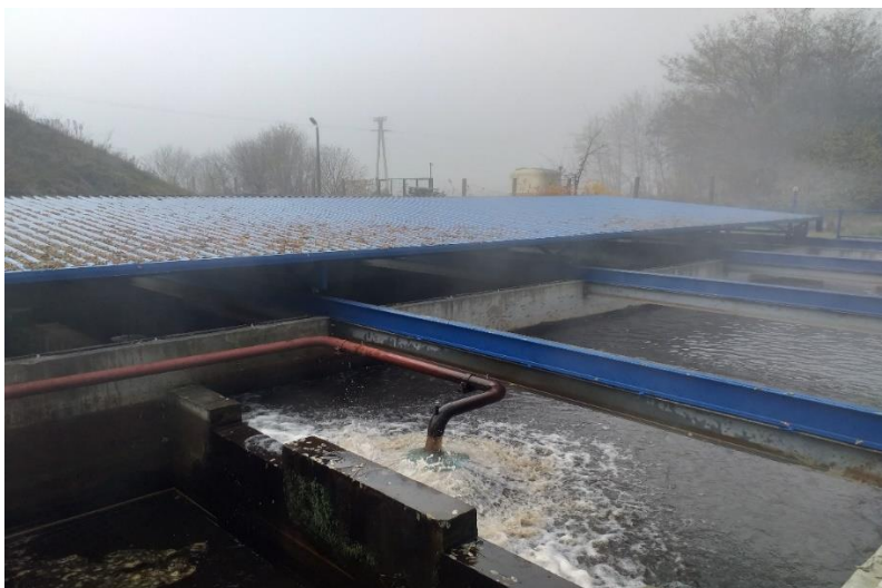
3. ábra: Geszteréd Vízműtelep arzénos vasiszap szikkasztó I. medence
