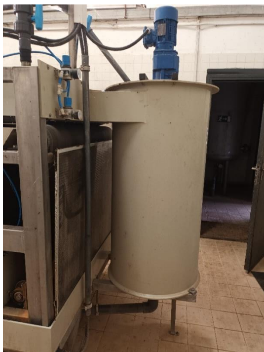
16. ábra: Hajdúhadház szennyvíztelep flokkulátor
