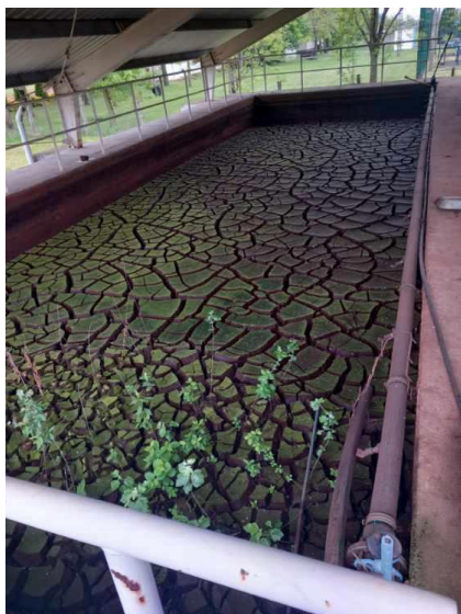
8. ábra: Hajdúnánás Vízműtelep iszap szikkasztó I. medence
