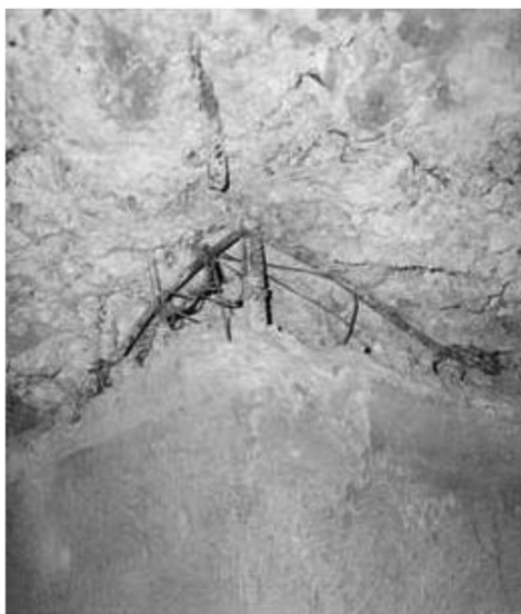
7. ábra: Kivitelezésből származó hiányosságok oszlop és oszlopfő találkozásánál (forrás: Dr. Bucur-Horváth Ildikó, Dr. Mátyás Gyöngyvér: Vasbeton silók jellegzetes károsodása és megerősítése I.)
