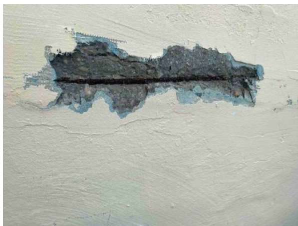
10. ábra: betontakarás leválása (szerző fényképe, készítés ideje: 2024.06.13.)
