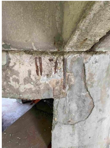
8. ábra: Betontakarás leválása (szerző fényképe, készítés ideje: 2024.06.12.)
