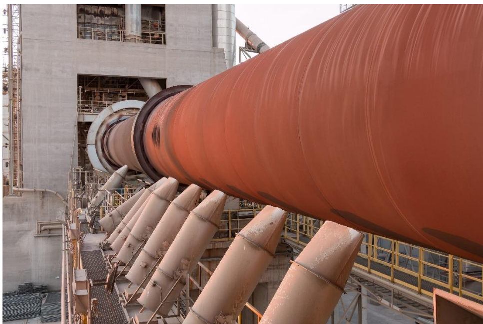
7. ábra: Cementgyár klinkerégető kemence
