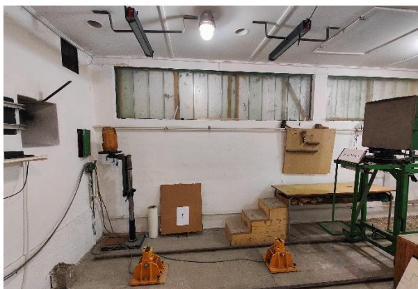
35. ábra – A lőfolyosón beszerelt fénykapuk
