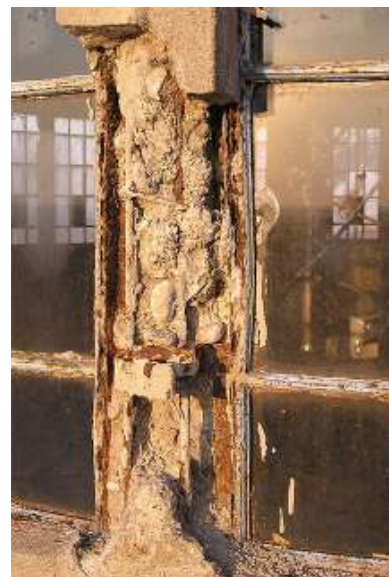
9. kép: Pillér károsodása [14]
