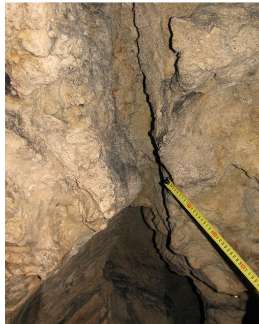
10. kép. Kitöltött repedés
