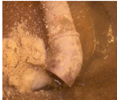
3-7. kép: Az első szűrőmező elfolyó vezetéke
