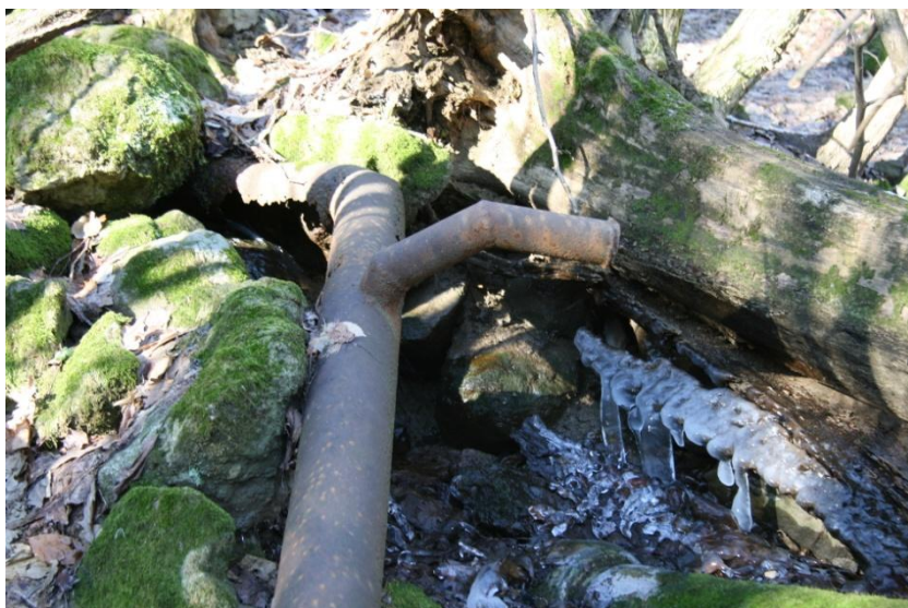
1. kép: Törött, rozsdás vezetékdarab, Lajos-forrástól kb. 500 m-re, feltehetően a Kékvízű-forrás kiépítésének maradványai, 2011. 01. 23.
