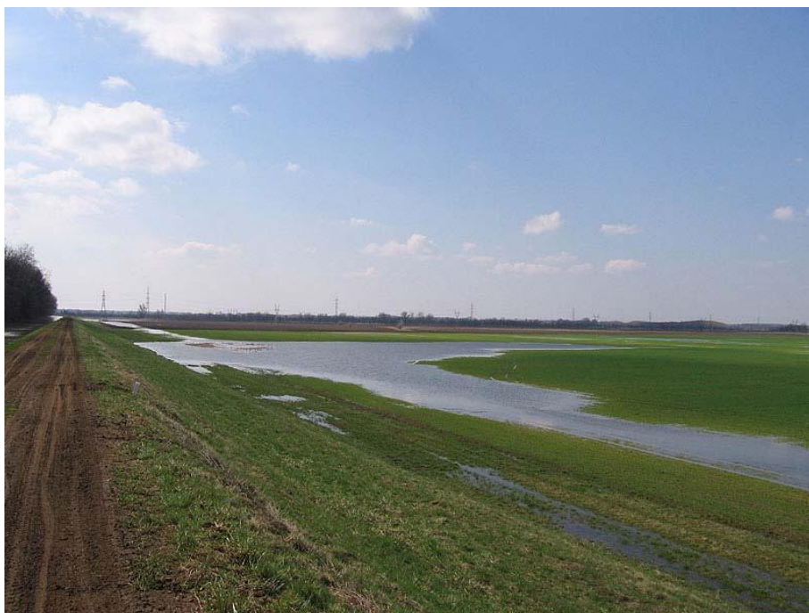
6. ábra: Átszivárgott víz a mentett oldali töltéslábnál.
