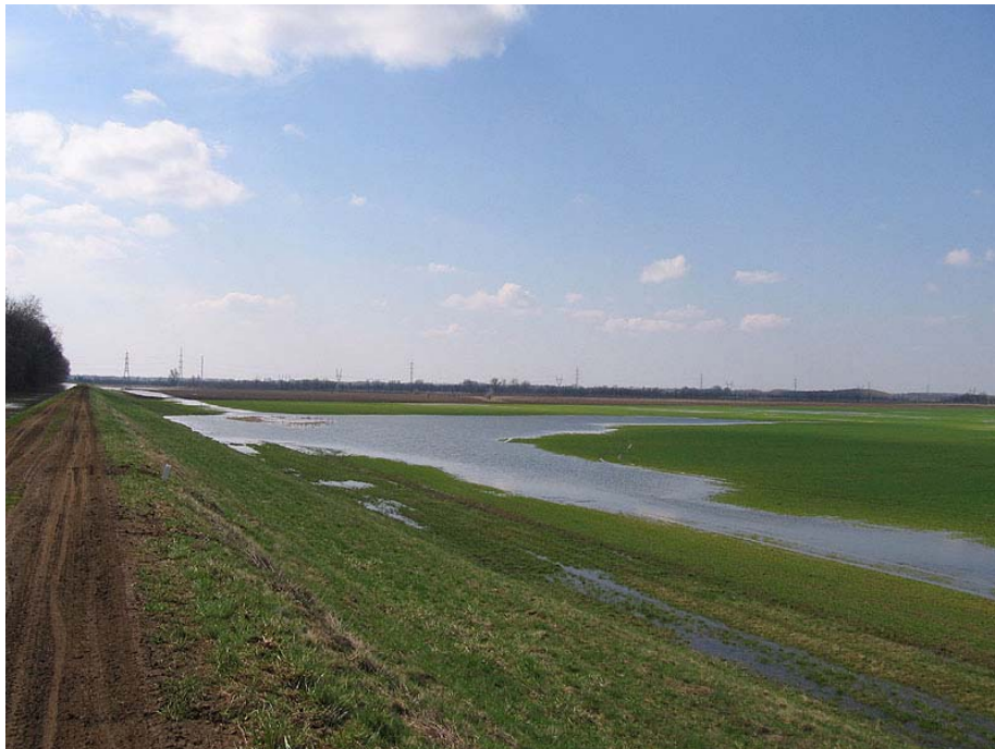
6. ábra: Átszivárgott víz a mentett oldali töltéslábnál.
