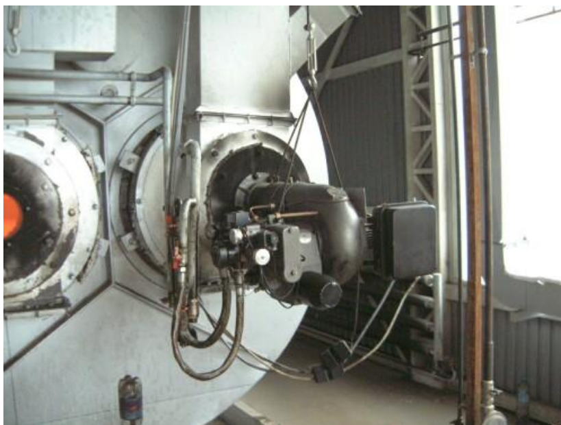
28 . ábra Utóégető berendezés
