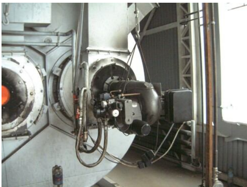
28 . ábra Utóégető berendezés
