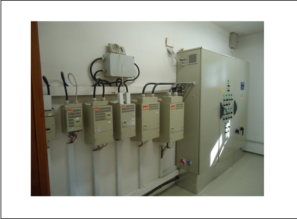
26. ábra Frekvenciaváltó berendezések (forrás: Veresegyház)
