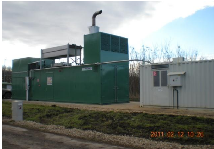
1.kép. A blokkerőmű, ami villamos energiát termel a biogázból (Fotó: Hankovszky G., 2011)
