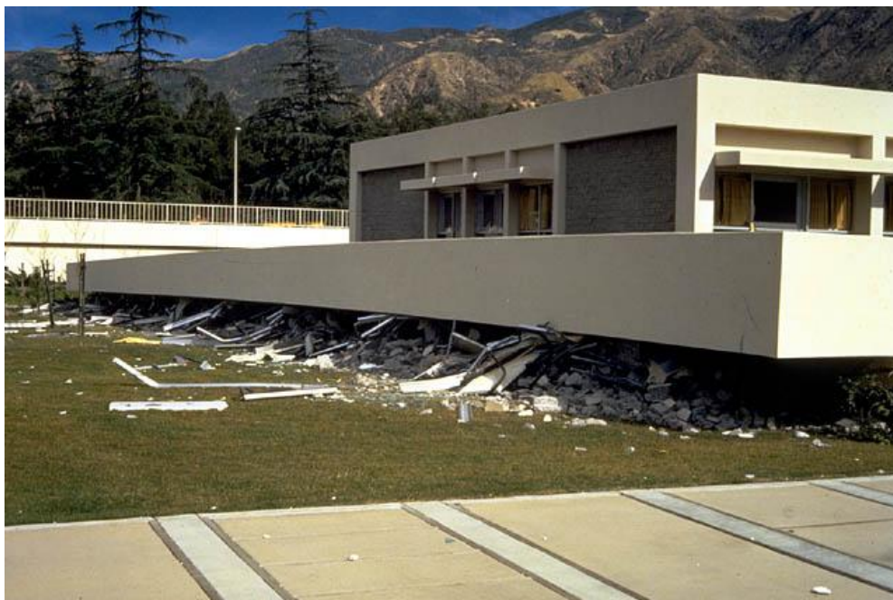
(50. ábra) a puha szint miatt a földszint teljesen megsemmisült
