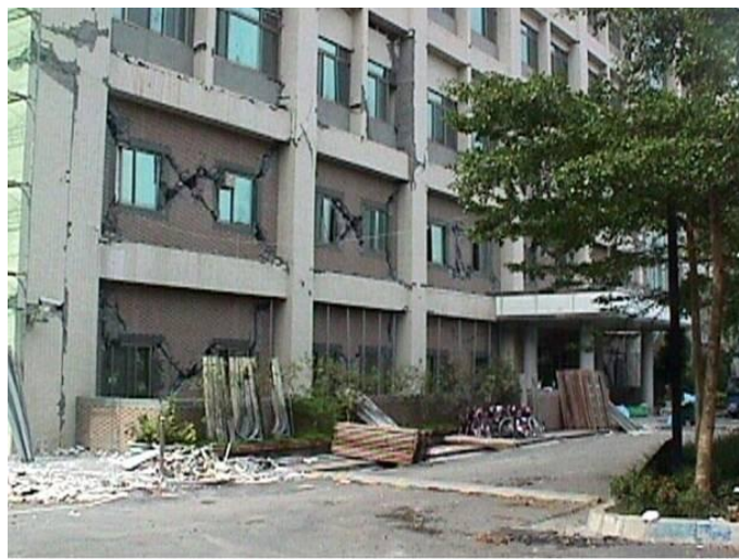
(61. ábra) jól látszódnak a keresztirányú repedések.
