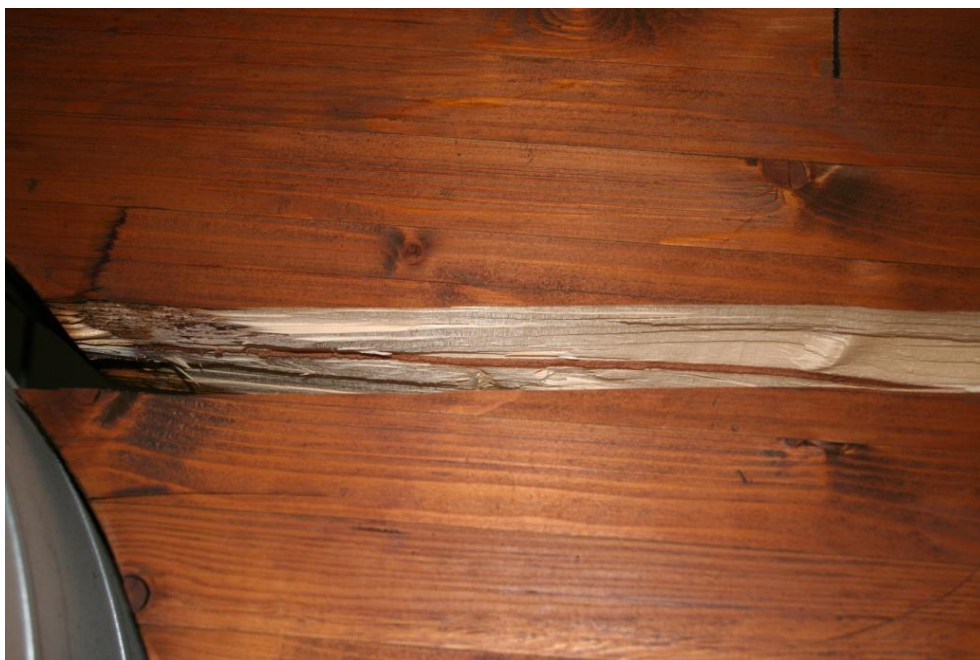
5. ábra: A tapolcai csarnok gerendájának tönkremenetele,
