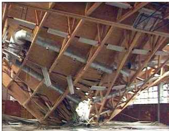
2. ábra: Az iskola tornatermének beszakadt tetőszerkezete (Forrás: http://www.konrad-fischer-info.de/DA02.JPG )
