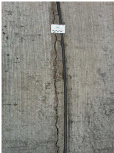
5. fénykép: A villamosvágány térbetonja dilatációjának él letörése
