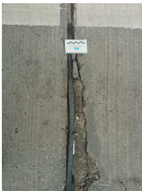
6. fénykép: A villamosvágány térbetonja dilatációjának él tönkremenetele
