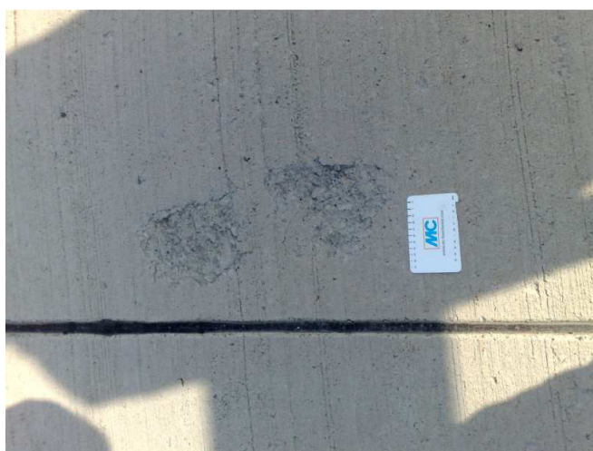
4. fénykép: A felületi nyomokban keletkezett felfagyás.
