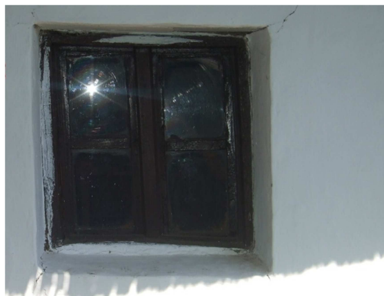
18. ábra: Az ablak deformációja (saját fotó)
