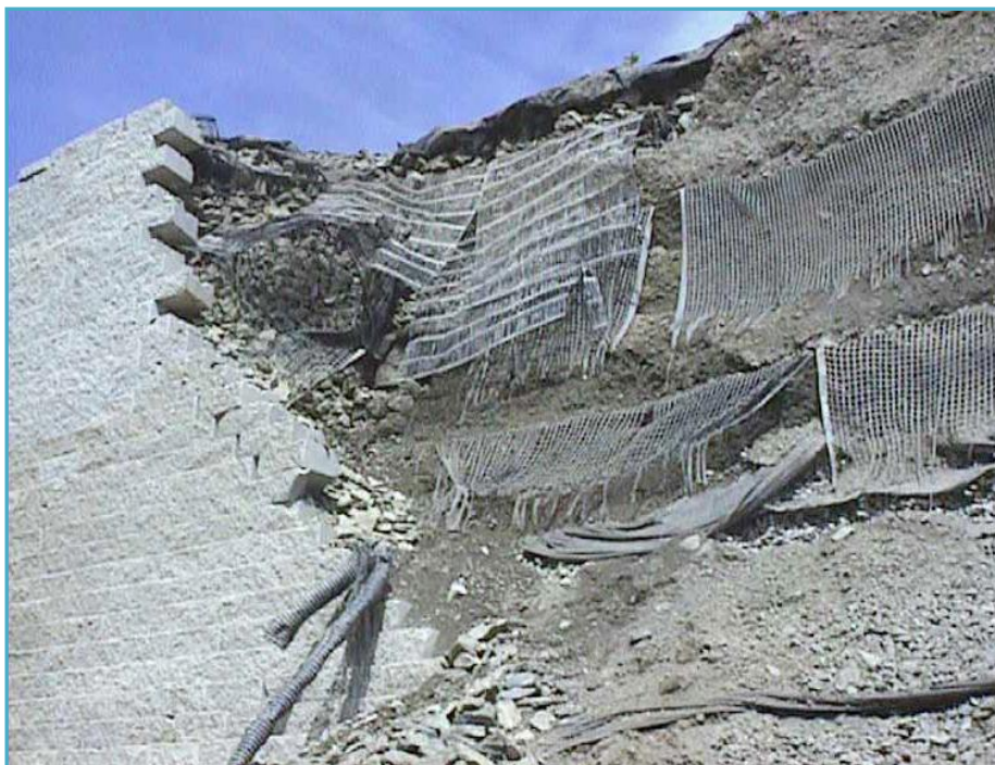
5. ábra: Rosszul megtervezett megerősítés következménye (Minnesota Department of Transportation, 2012)
