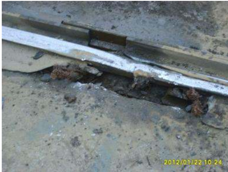
1. Fénykép: Petőfi híd sándilatációs szerkezetének kóboráram okozta tönkremenetele
