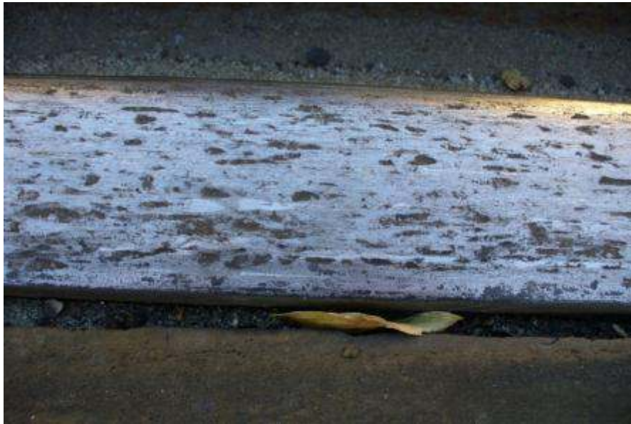
5. Fénykép: Hosszirányú meghibásodás a sínfejen
