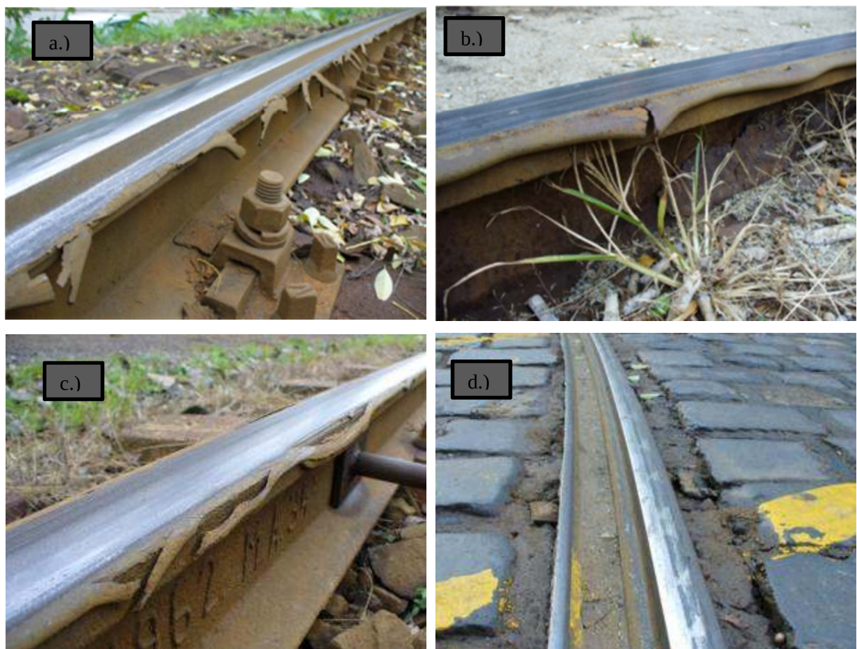
12. Fénykép: (a) Oldalkopás legyűrődése ívben; (b) A sínfej legyűrődése; (c) A sínfej futófelületének lemezes legyűrődése; (d) Széles nyomcsatorna a sínfej kopása miatt
