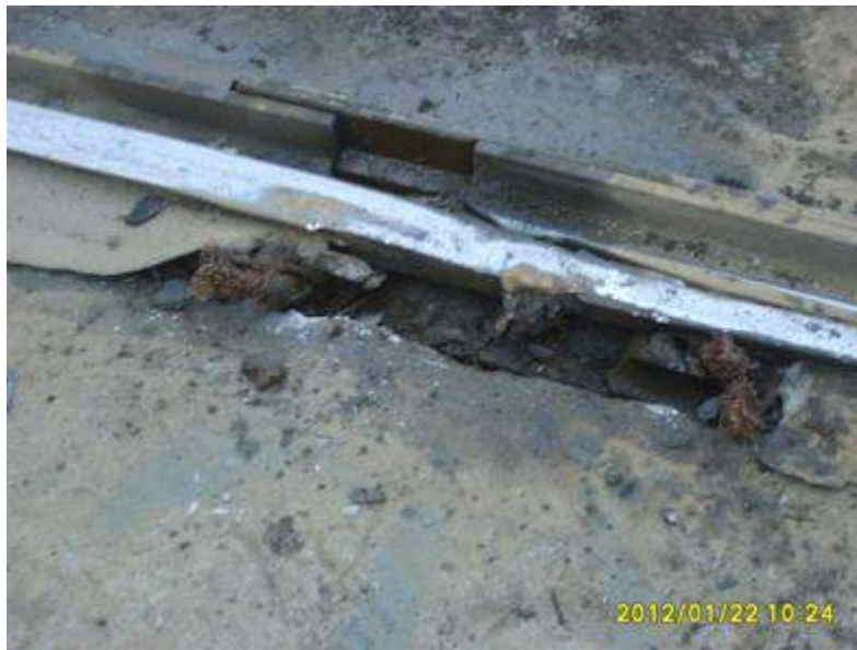
7. Fénykép: Petőfi híd síndilatációs szerkezetének kóboráram okozta tönkremenetele
