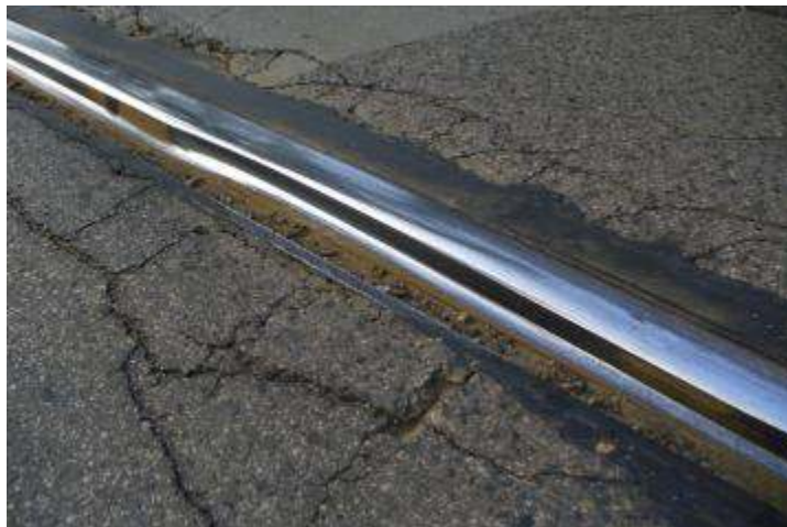
10. Fénykép: A sínorr hullámos oldalkopása
