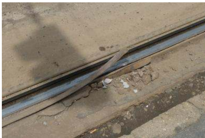
8. Fénykép: Felhajlott acél síncsatorna
