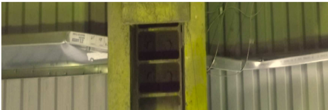
5. kép: Tönkrementel a közbső támasznál és a szabad öv kifordulása
