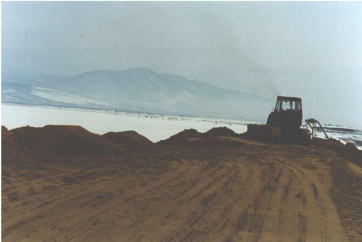
4.4. ábra: Az Aurul zagytározó átszakadt gátja, melyen az átszakadás utáni töltést gépekkel tömörítik. (mokkka.hu, etk.hu)
