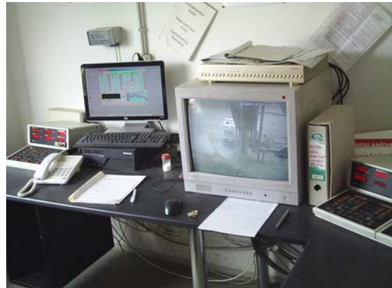
2. ábra: A gyártást vezérlő számítógép
