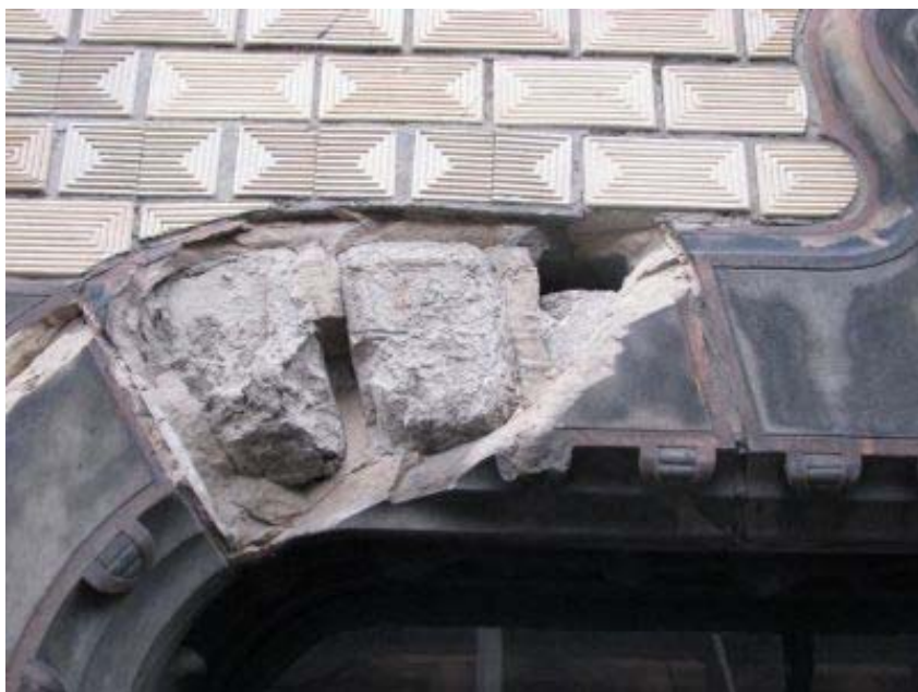
3.7. kép: Hiányzó ablakkeret elem
