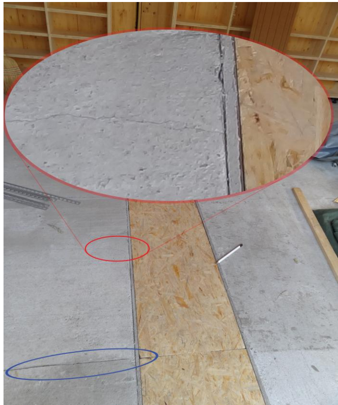
47. ábra: Húzási repedés az aljzatbetonon és bemarkolás a fugahézagban
