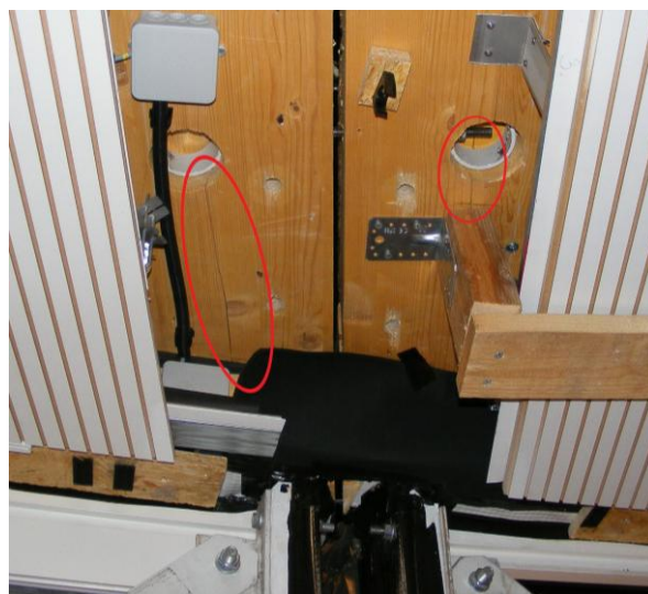
53. ábra: Tönkrement gyűrűs kapcsolat
