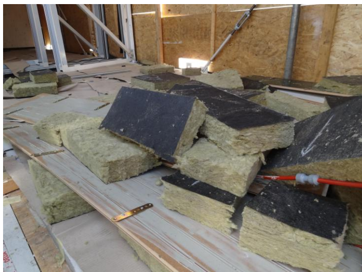
51. ábra: A kamionok érkezésekor a lehullott álmennyezeti elemek
