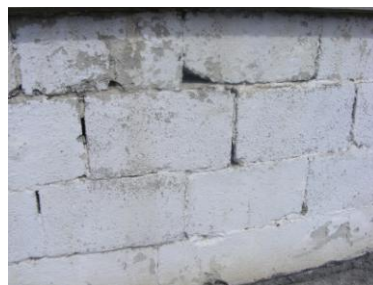
R14-es ház szakszerűtlen falazása (49. kép)
