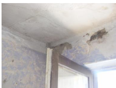
SZ53-as házban a fal felső részének károsodása (36. kép)
