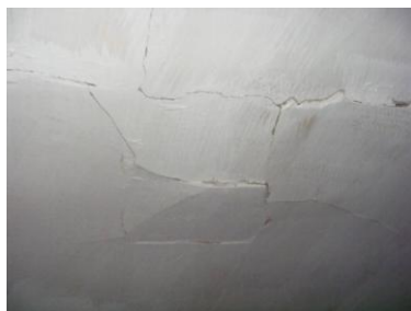
Falazat repedezése (65. kép)
