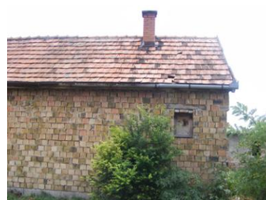
Helytelen kivitelezésű falazás (61. kép)
