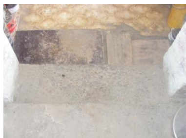
Padlóburkolat hiánya (62. kép)
