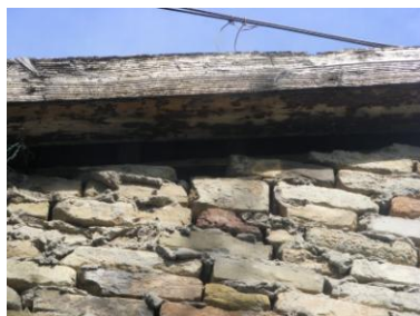
Szakszerűtlen falazás (60. kép)
