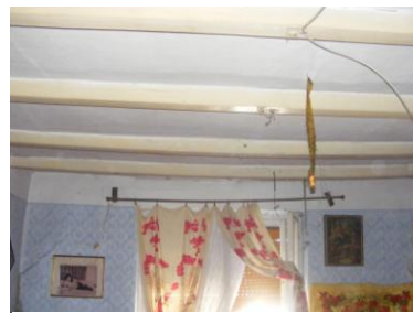
SZ65-ös házban a födém meghajlása (37. kép)
