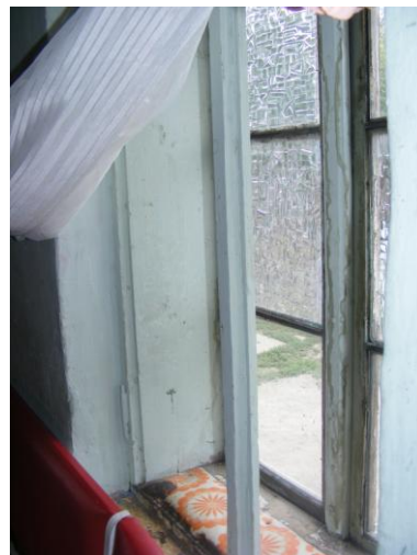
Hiányzó ablakszárnyak (70. kép)
