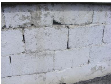
Nagy rések a falazóblokkok között (59. kép)
