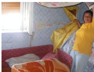
SZ65-ös ház repedéseit mutatja az ott lakó asszony (39. kép)
