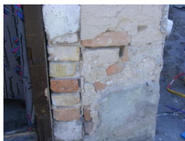
V4-es ház bejáratánál lehullott a vakolat (51. kép)
