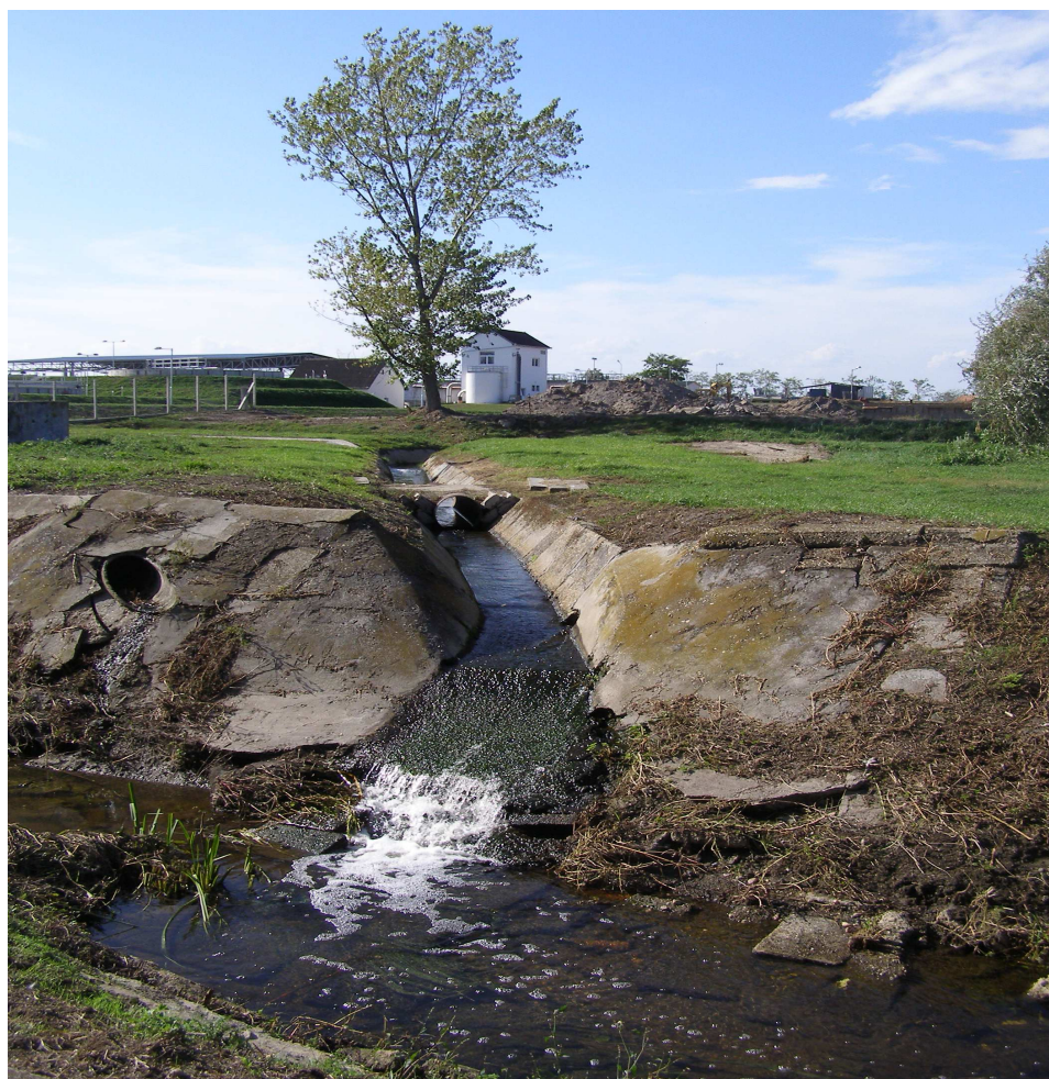
4. ábra a Nagykőrösi szennyvíztisztító telep tisztított szennyvíz bevezetése
