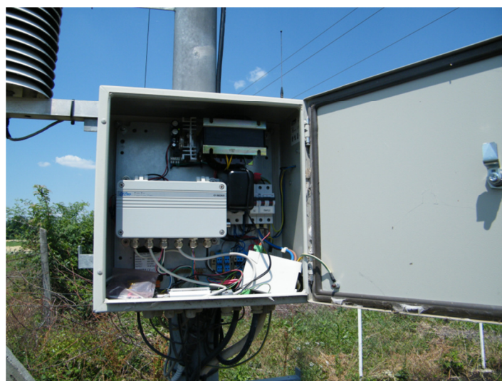
2. kép: Elektromos hőmérő(bal felső sarok) és adattovábbító állomás
