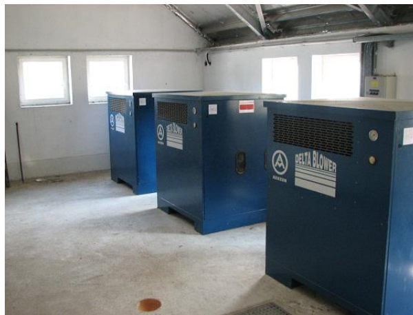
8. kép: Levegőbefúvó berendezések a solymári telepen (2012.09.16)
