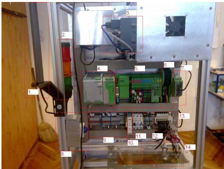
11. ábra – a megvalósított vezérlőszekrény
