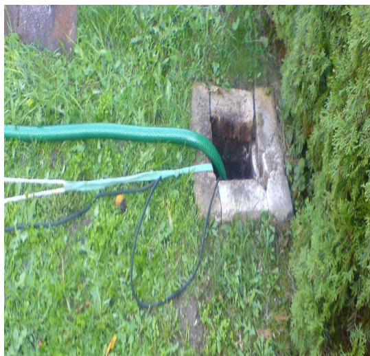
5. ábra Tároló ürítése szivattyúval
