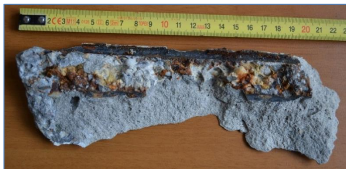
6.15. ábra: Tokvégről levált darab (Kép készült: 2013. 05. 06.)
