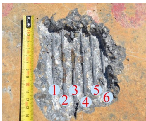
6.25. ábra: Hozzávetőlegesen 4×5 cm kiterjedésű rozsdafolt feltárása (Kép készült: 2013. 07. 22.)
