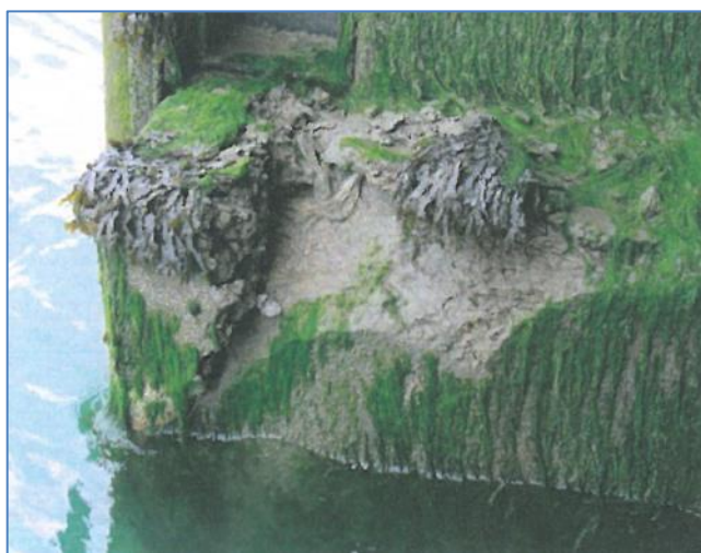
2.12. ábra: A beton korróziójához hozzájárultak a biológiai hatások [fib bulletin 53]
