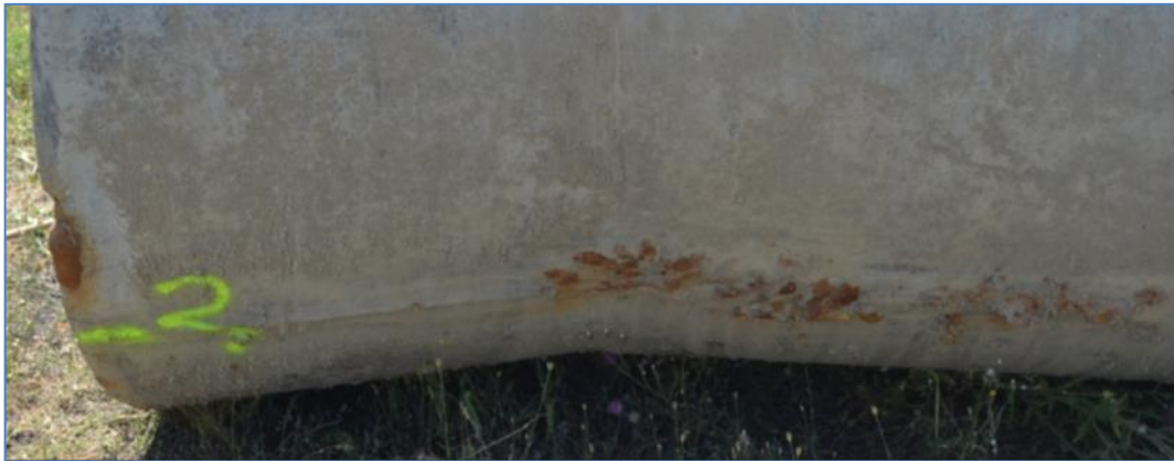
M.15. ábra: Zsaluillesztésnél észlelt rozsdafolt üzemén kívüli csövön (Kép készült: 2013. 07. 17.)
