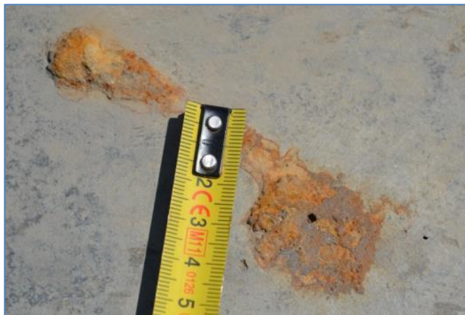
M.20. ábra: Beton felületén észlelt rozsdafolt a rozsdatermék eltávolítását követően, kép készült: 2013. 07. 17.)
