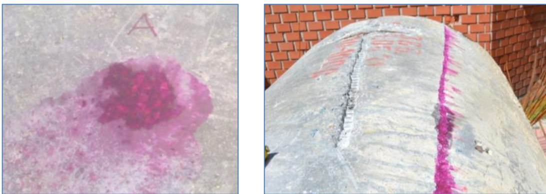
3.8. ábra: Karbonátosodás vizsgálata fenolftalein oldattal a cső általános részén (Bal oldali kép készült: 2012. 07. 16., jobb oldali kép készült: 2012. 08. 06.)
