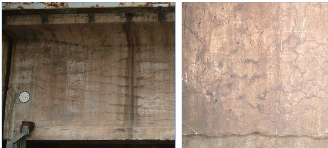
4.8. ábra: Kínában levő Daqing vasúti hídon tapasztalt repedések az alkáli-adalék reakció hatására [inti.gob.ar]
