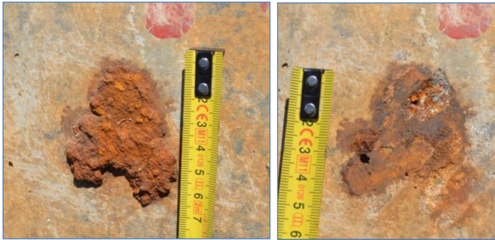
M.19. ábra: Beton felületén észlelt, hozzávetőlegesen 5×4 cm kiterjedésű rozsdafolt a felmérés kezdetén és a rozsdatermék eltávolítását követően, képek készültek: 2013. 07. 17.)
