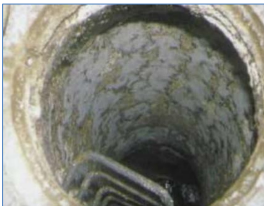
4.4. ábra: Szennyvízakna károsodott betonfelülete [Pethő, 2013]
