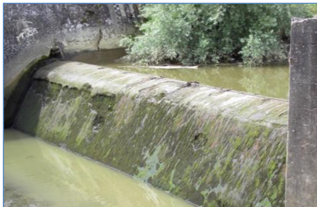
4.11. ábra: Szentgotthárdnál levő zsilip betonjának korróziója a víz koptató hatása, illetve a megtelepült növényzet miatt [Nehme, 2013]
