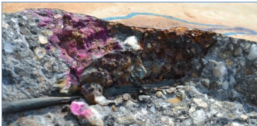
3.11. ábra: Repedés felülete nem színeződött el a fenolftalein oldat felhordása után (Kép készült: 2013. 07. 18.)
