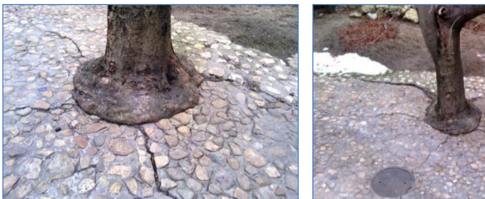
4.12. ábra: Betonburkolat tönkremenetele fa gyökérzetének feszítő hatása miatt (Kép készült: Sopron, 2013. 02. 09)
