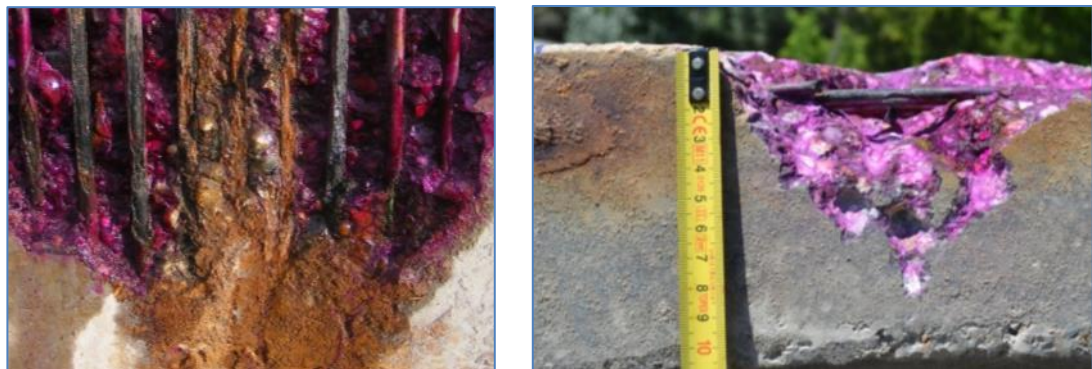
3.9. ábra: Karbonátosodás vizsgálata fenolftalein oldattal rozsdafoltok környezetében (Bal oldali kép készült: 2010. 11. 04., jobb oldali kép készült: 2013. 07. 22.)
