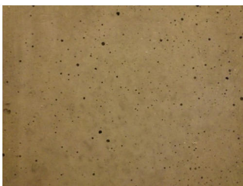
2-23. ábra: Porózus betonfelület
