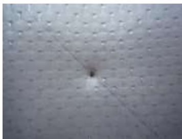
Az átszűrődött vízszigetelés
