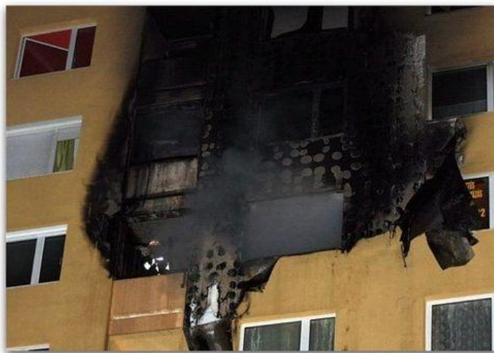
2. kép Leégett polisztirol szigetelés
