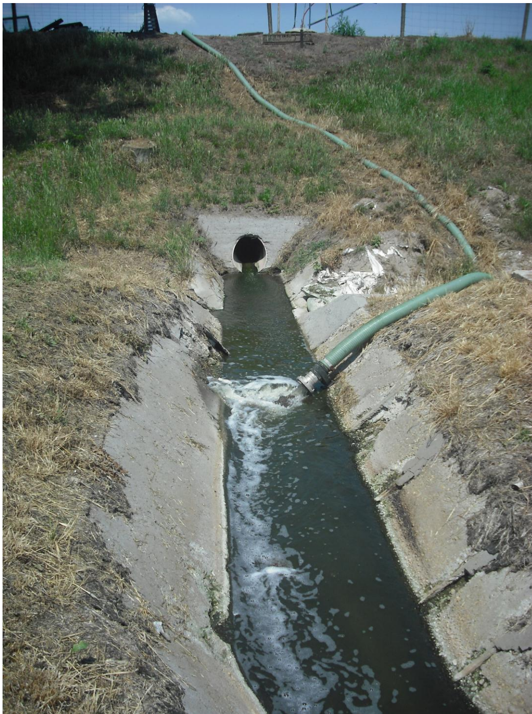
2. ábra Tisztított szennyvíz bevezetése az átépítés előtt
