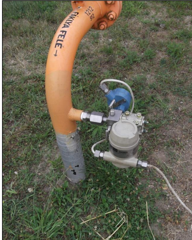
4-2. ábra: Beépített annubar szonda a lefűtő vezetéken (Forrás: Saját készítésű kép)
