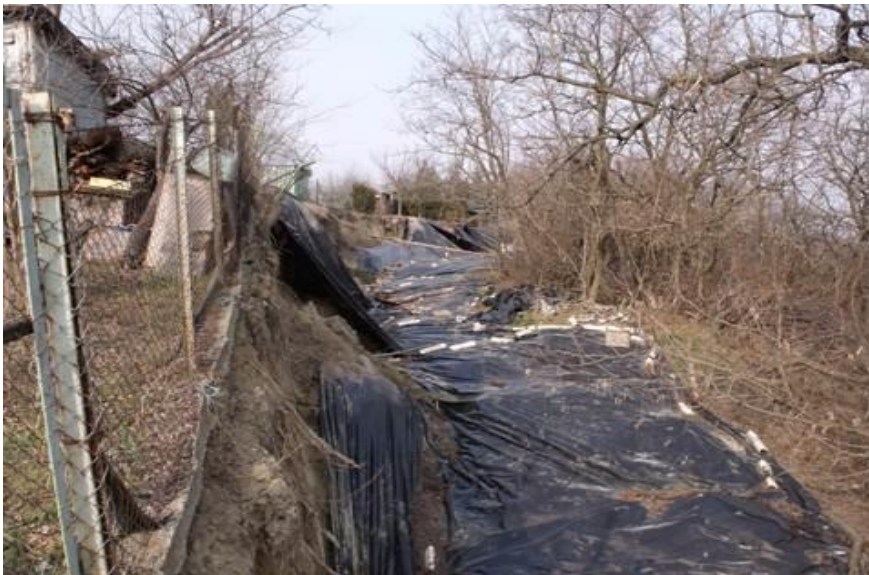
12. kép Ivó utcával párhuzamos szakadás 1/4 (2011-01-21) (Forrás: Sycons Kft.)
