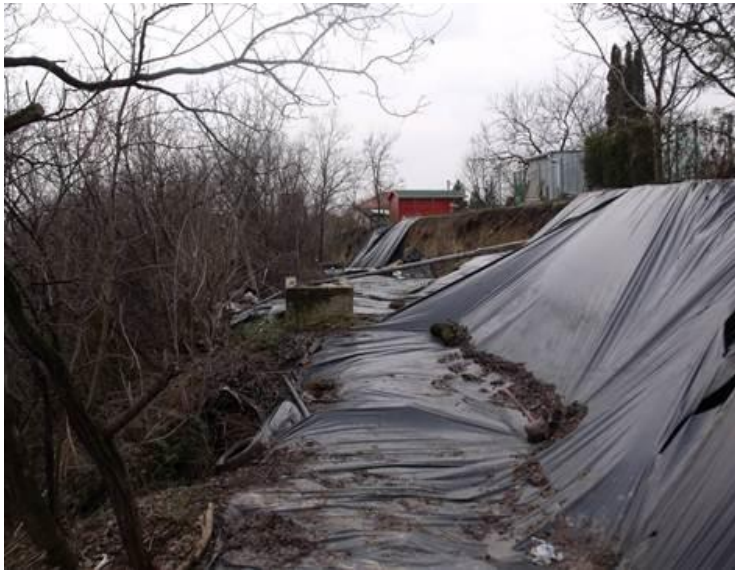
11. kép Ivó utcával párhuzamos szakadás 1/3 (2011-01-21) (Forrás: Sycons Kft.)
