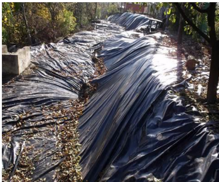
10. kép Ivó utcával párhuzamos szakadás 1/2 (2010-11-05) (Forrás: Sycons Kft.)
