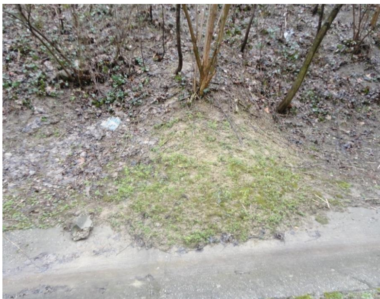
11. ábra: A vízelvezető betonvályúba belenyúló földnyelv (a bányaudvar peremén, a rézsű lábánál)
