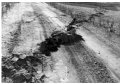
15. ábra Lassú mozgások okozta repedések az utakon (forrás: http://www.partvedelem.hu/visszatekinto.htm )
