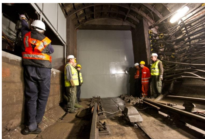
33. ábra Óvóhelyi berendezések ellenőrzése a kettős metróon
