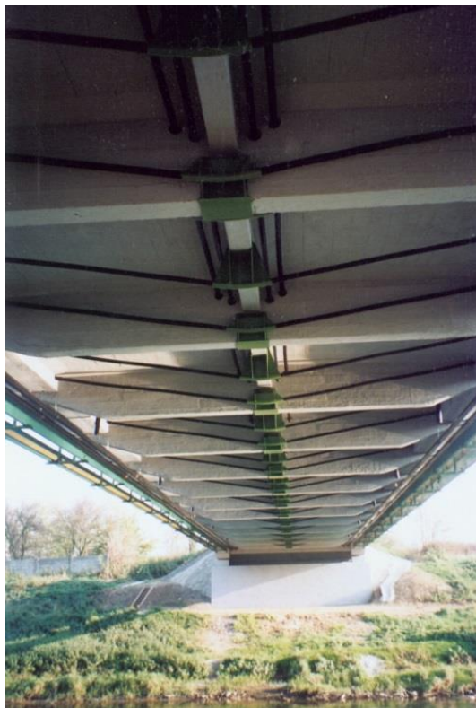
27. ábra Külső utófeszítés vasbeton tartószerkezeten
